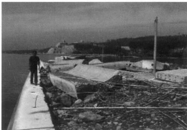
写真-5 手場地区の被災状況
